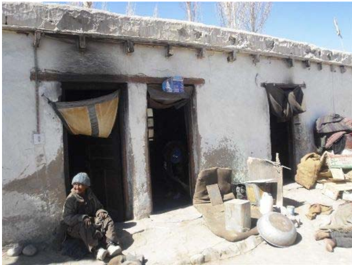
Desaströser Zustand des Altbaus
